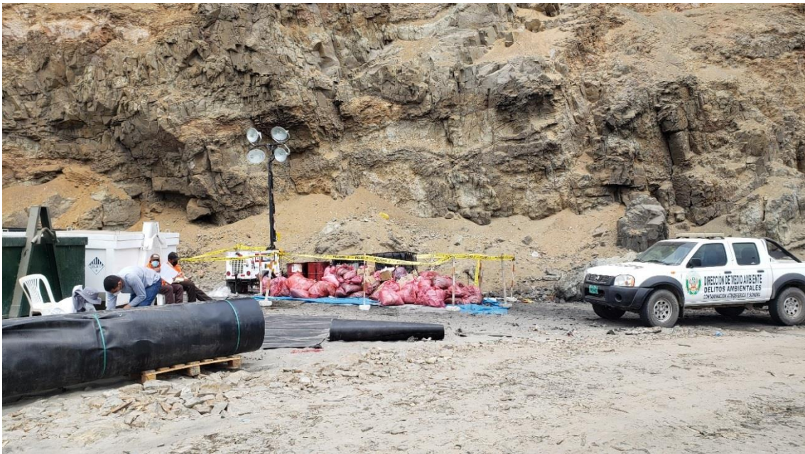
Fotografía 14. Falta de señalética entre las zonas de aparcamiento y de almacenamiento final (plataforma estanca)
